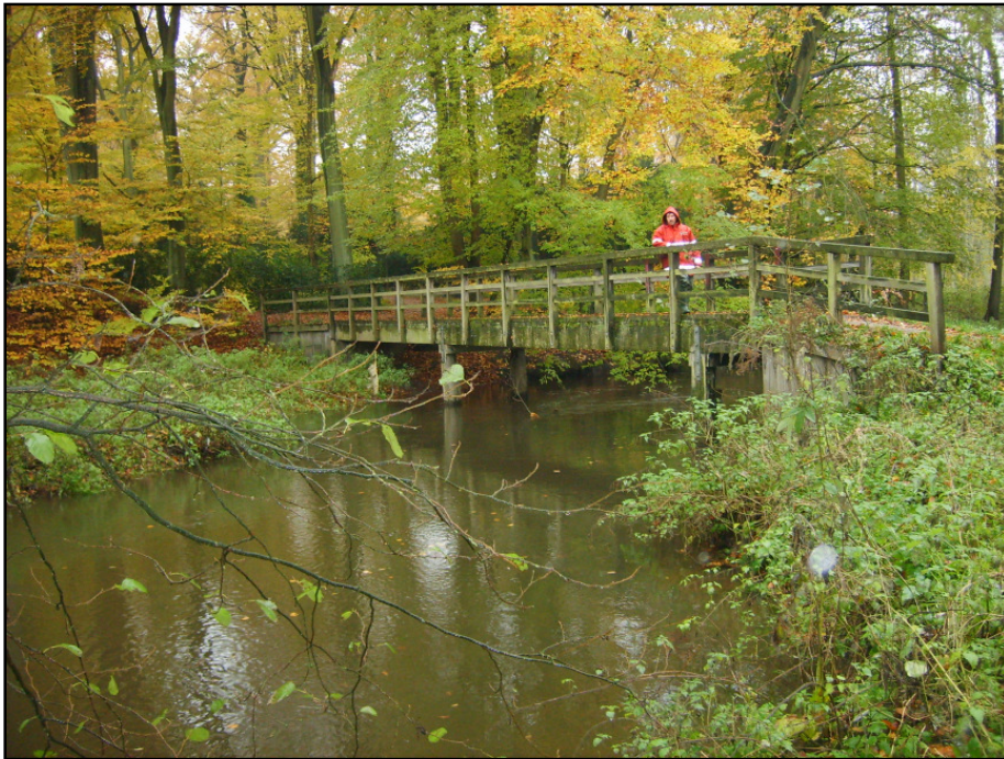
Abb. 22 Brückenbauwerk mit Bedarf für Gehölzpflege
