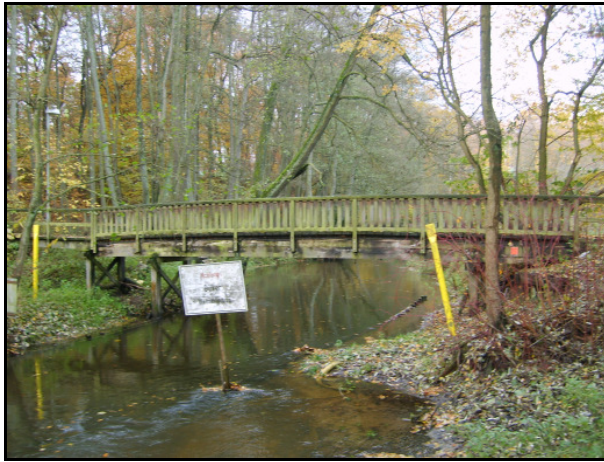
Abb. 11 Fußgängerbrücke mit Gefährdung der Standsicherheit/Rückstau (Stat. 13+613)
