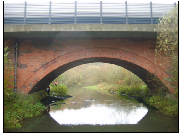
Abb. 12 Eisenbahnbrücke ohne Gefährdung der Standsicherheit/Rückstau (Stat. 8+413)
